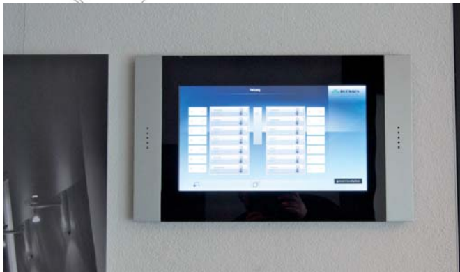
Jungs Facility Pilot überwacht die Hauselektrik und liefert ansprechende Visualisierungen
